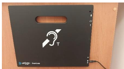
Zdjęcie nr 18: Zakup i instalacja mobilnej petli indukcyjnej
