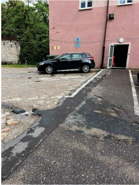
Zdjęcie nr 11: wymagające remontu miejsca parkingowe
